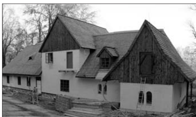
Obr. č. 11 – Slatiňany – Švýcárna, jižní průčelí, stav během rekonstrukce listopad 2011 (foto Ing. J. Hodič)
