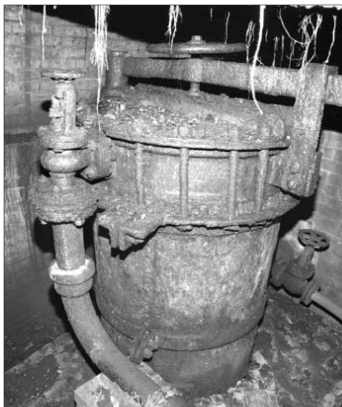
Zařízení k úpravě vody před zámek (foto Ing. Hodic, 2012)
