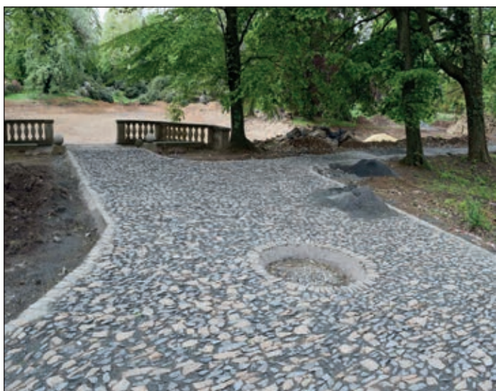
Obnovená původní dlažba u přístaviště, v pozadí vybagrované jezírko připravené na položení izolační folie.
